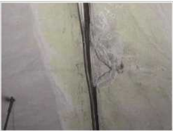
Span 6 천장부 라이닝 조인트부 파손
