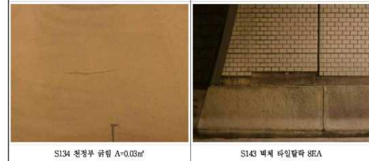
S134 천정부 균열 A=0.03㎡
