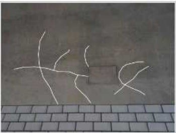
Span 6 어깨부 라이닝 망상균열
