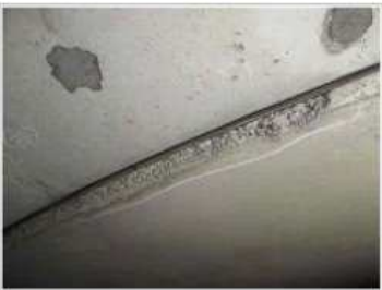
Span 1 경문부 라이닝 재료분리
