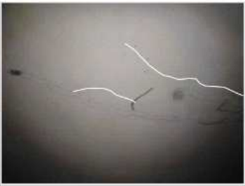
Span 7 천장부 라이닝 균열 cw=0.3mm
