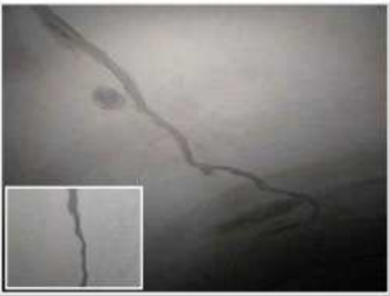
Span 12 천장부 보수부 재균열 cw=0.2mm
