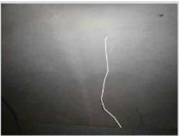
Span 3 어깨부 라이닝 횡방향 균열 cw=0.2mm
